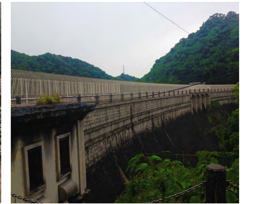
堰堤（北側）度重なる放水、風化により表面は老朽化
